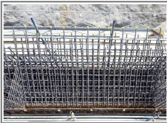
●ごみピット壁配筋のようす 太い鉄筋が網の目の様に組まれています。
