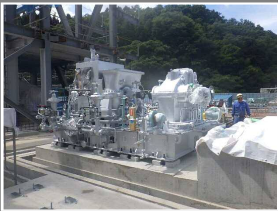
● 蒸気タービン発電機（蒸気タービン部分）【9月4日撮影】 ボイラからの高圧蒸気を利用してタービンを回転させて発電します。回転振動の影響を遮断するため、建物から完全に分離した独立基礎の上に設置しています。
