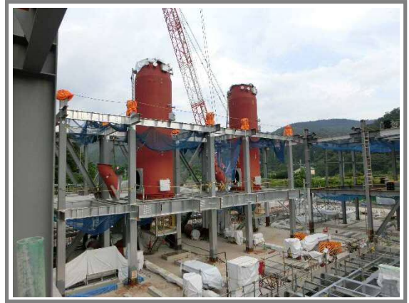
● 減温塔【9月1日撮影】 排ガスに水を噴霧し、温度を下げる装置です。処理棟の2階から4階までを貫通する高さがあります。
