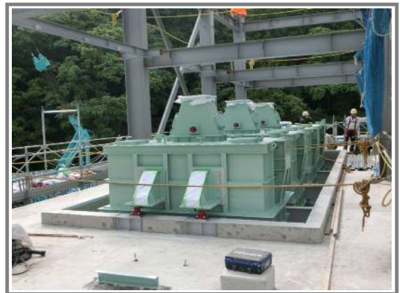
● 各種バンカ【8月29日撮影】 ごみから回収した鉄、アルミや飛灰処理物を一旦貯留し、ダンプトラックに積み込む装置です。
