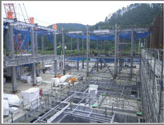
● 炉室のようす【8月28日撮影】 ガス化炉、熔融炉、ボイラ等を設置するエリアの1階部分の床をつくっています。
