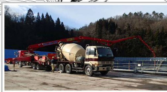
【コンクリートミキサー車、ポンプ車】 地下部のコンクリートを打設しています。
